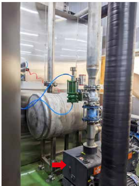
真空預冷系統用無油真空泵（箭頭所指）。（來源：李允中）
