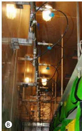
蒸熱檢疫處理設施
